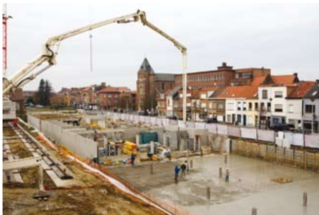
Fig. 58 : Pompage du béton frais, facilitant sa mise en oeuvre sur des chantiers vastes et/ou difficilement accessibles
